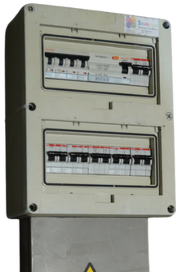
CUADRO 3 KWs QUADRO ELÉTRICO 3 KWs
