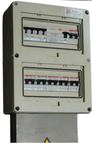
CUADRO 5 KWs QUADRO ELÉTRICO 5 KWs
