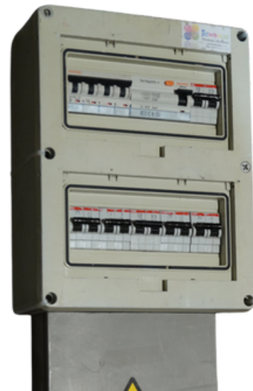
CUADRO 15 KWs QUADRO ELÉTRICO 15 KWs
