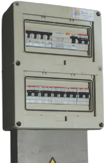
CUADRO 10 KWs QUADRO ELÉTRICO 10 KWs
