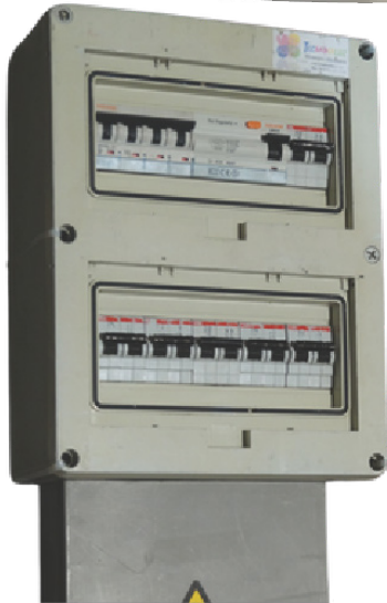
CUADRO 5 KWs QUADRO ELÉTRICO 5 KWs
