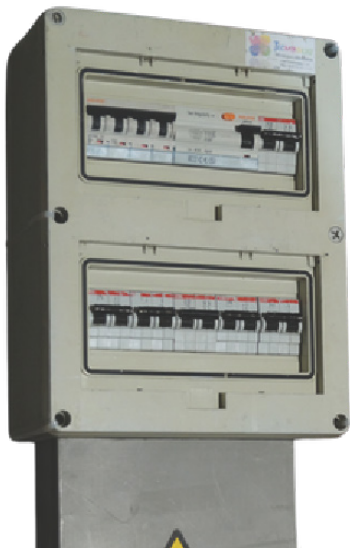
CUADRO 15 KWs QUADRO ELÉTRICO 15 KWs
