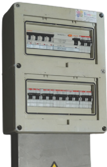
CUADRO 3 KWs QUADRO ELÉTRICO 3 KWs
